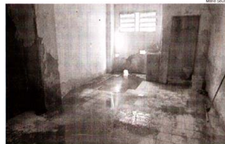
Banheiros oferecem riscos à saúde
